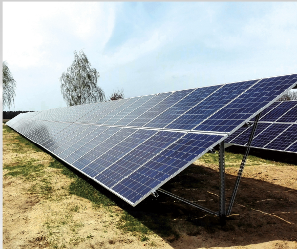
Bierutów nearby Wrocław— 2MW
